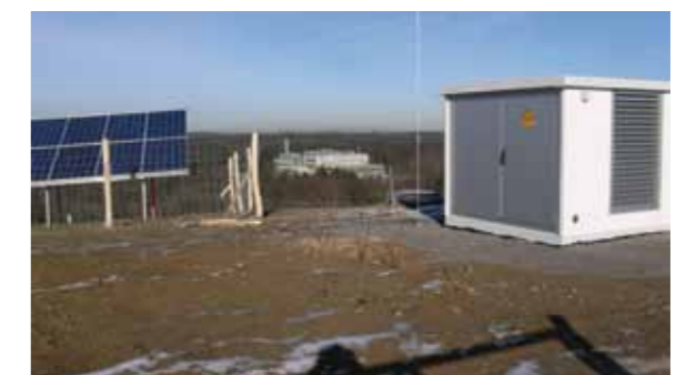
Trafostation mit Blick zum Restmüllheizkraftwerk
