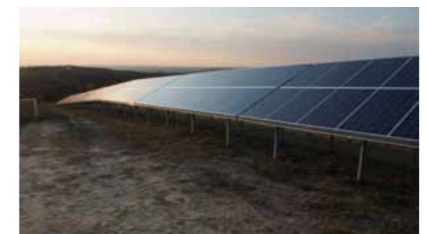
Abendstimmung über der PV-Anlage
